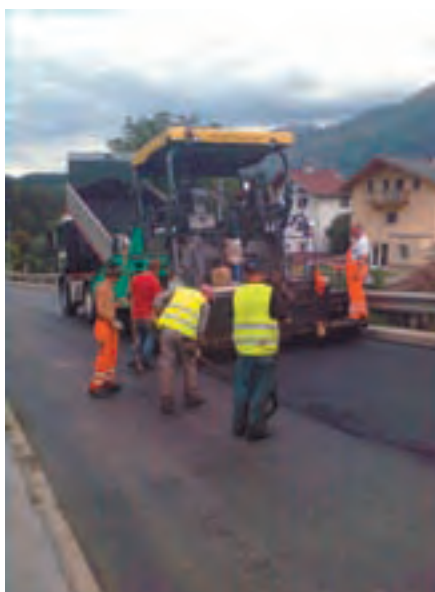
Neuasphaltierung der Landesstraße vom Kreisverkehr bis zur Engstelle Perkhofer durch die Landesstraßenverwaltung.
